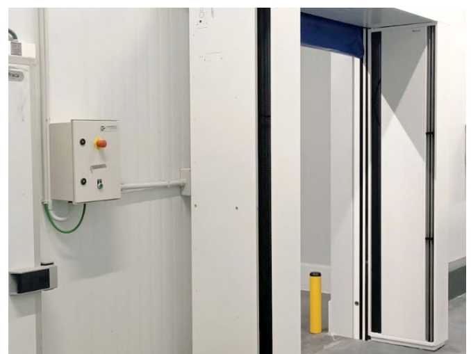
Twin K Instal·lació en la fàbrica d'una cadena de supermercats
