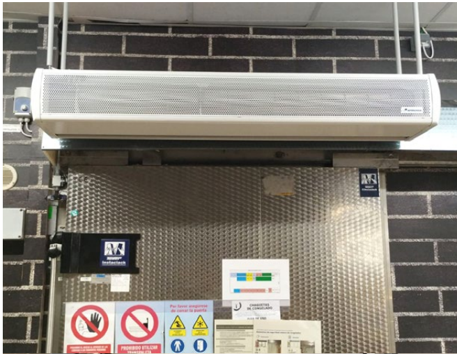
Optima K Instal·lació en un fàbrica de productes congelats
