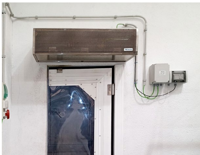
Fly K Instal·lació IP55 en la porta de servei d'una fàbrica
