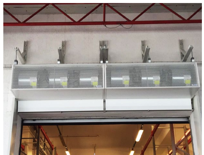
Fly KXL Instal·lació en una fàbrica de productes làctics
