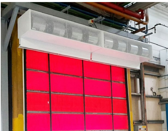
Fly KXL Instal·lació múltiple en una fàbrica de productes químics
