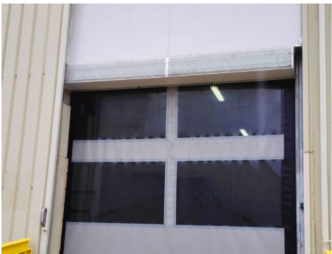
Fly KBB Instal·lació múltiple exterior en una empresa farmacèutica
