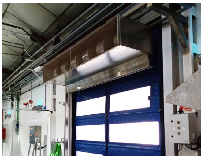
Fly KXL Instal·lació en una fàbrica d'anxoves i sardines
