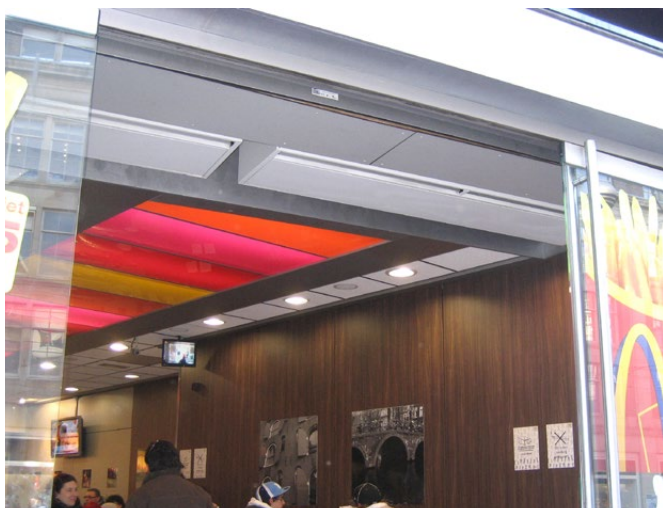
Fly K Instal·lació múltiple en un restaurant de menjar ràpid
