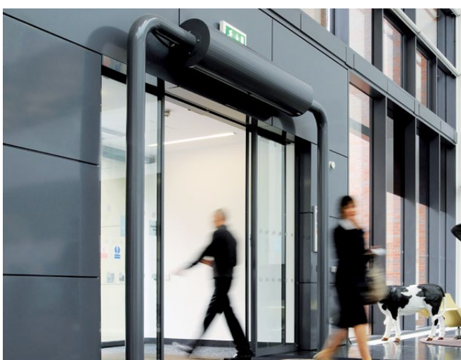
Rund Instalación horizontal con soportes en porteria
