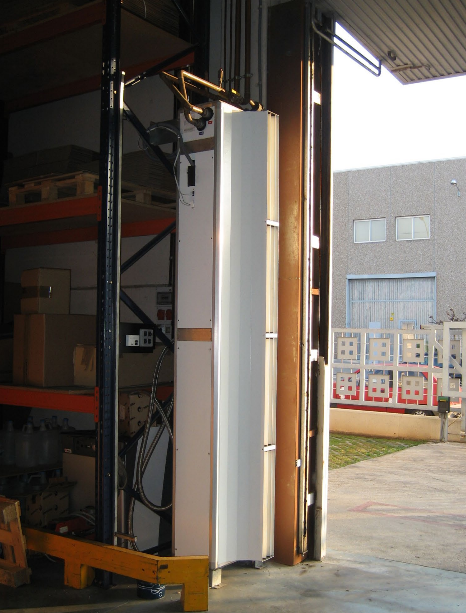
MAX, instalación vertical Airtécnic, Castellar del Vallès (España)
