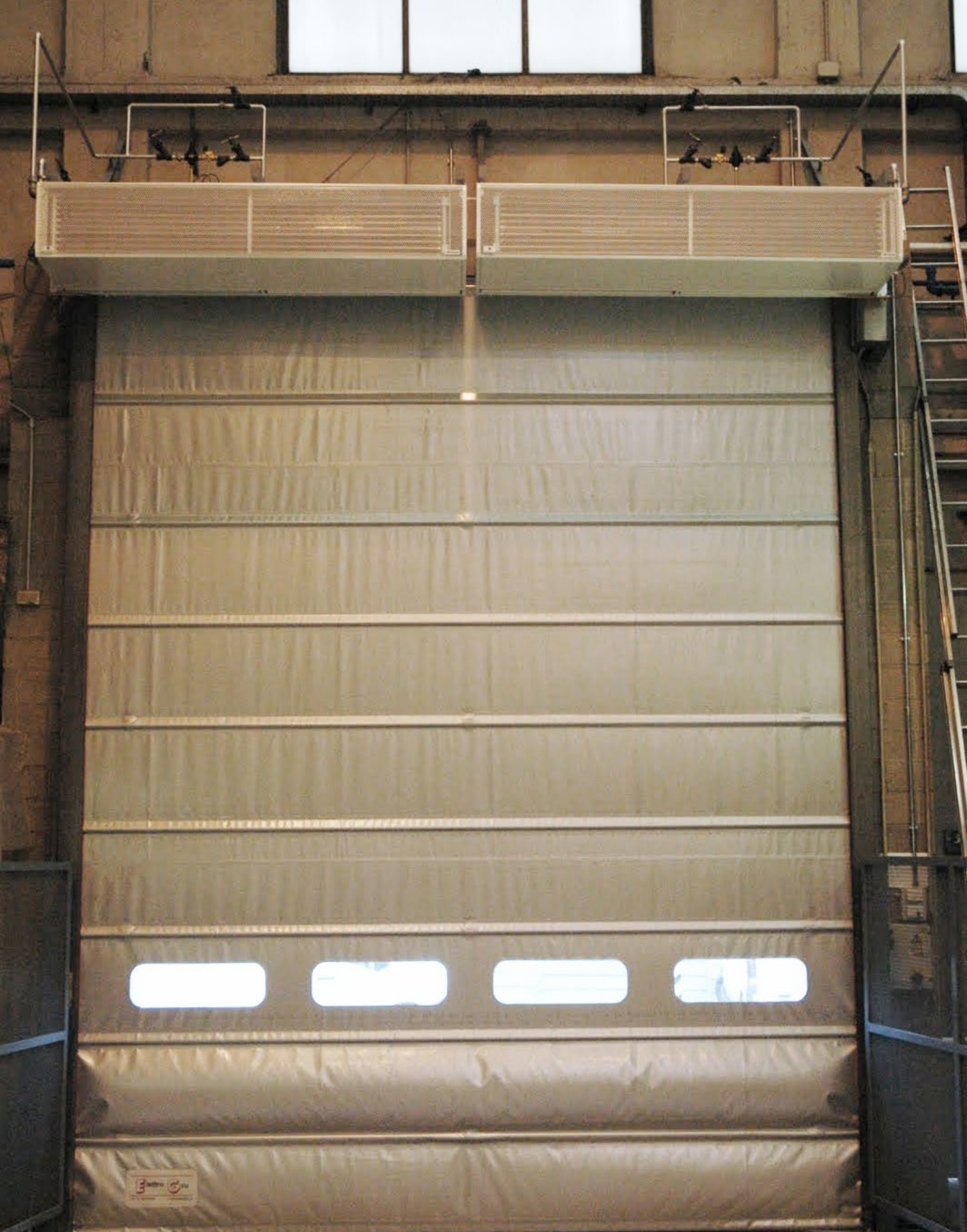
WINDBOX XL, instal·lació múltiple amb bomba de calor Fàbriques d'automòbils PIRELLI, Milano (Itàlia)
