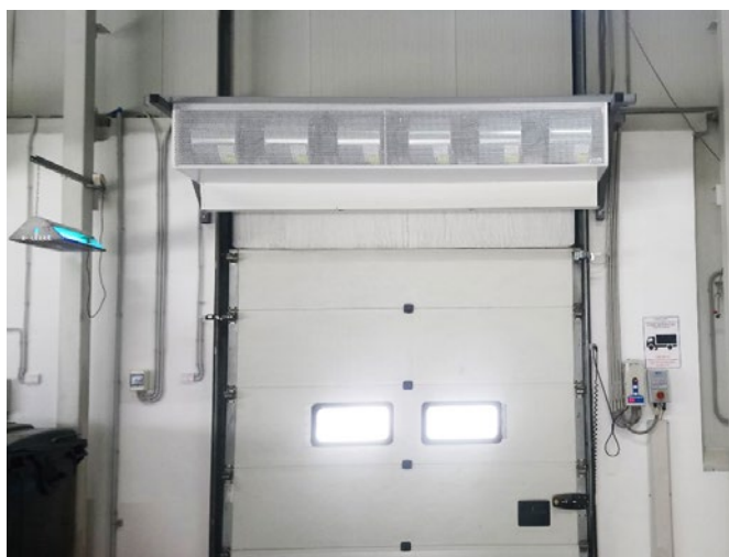
Fly KXL Instalación en la puerta de una fábrica
