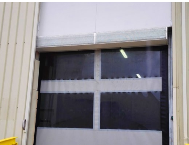
Fly KBB Instalación múltiple exterior en una empresa farmacéutica
