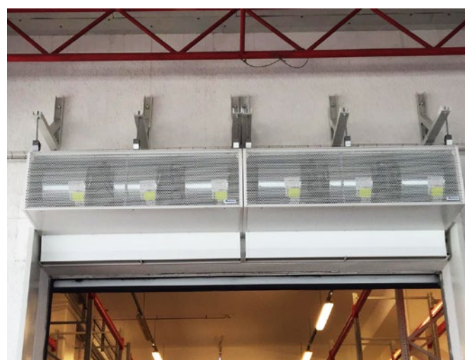
Fly KXL Instalación en una fábrica de productos lácteos
