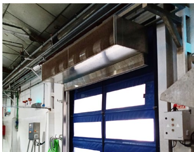
Fly KXL Instalación en una fábrica de anchoas y sardinillas
