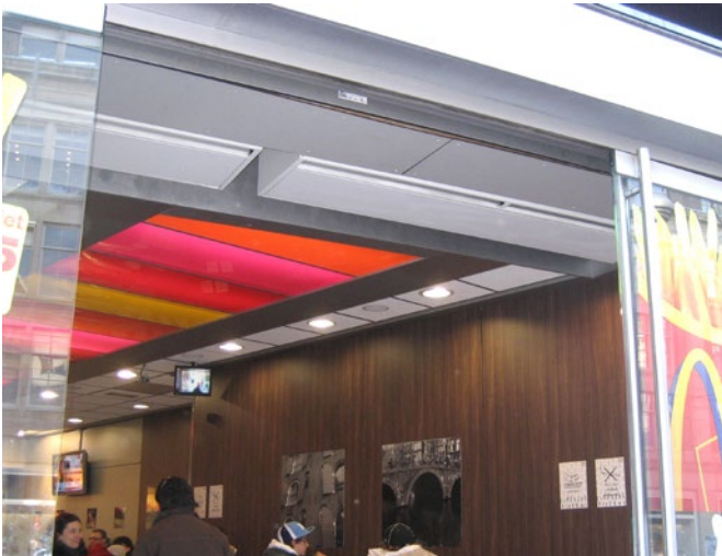
Fly K Instalación múltiple en un restaurante de comida rápida
