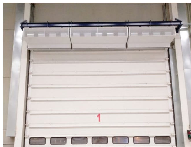
Fly KXL Instalación múltiple en una fábrica del sector energético
