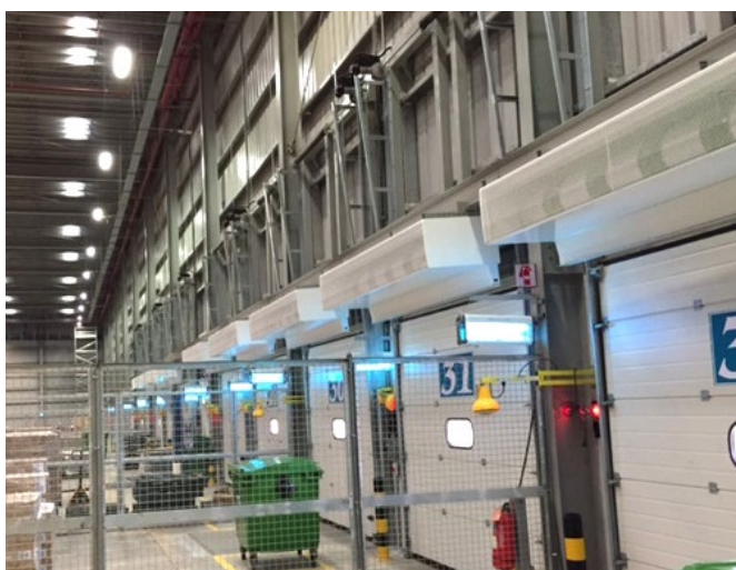
Fly KXL Instalación múltiple en una fábrica de cosméticos y jabones
